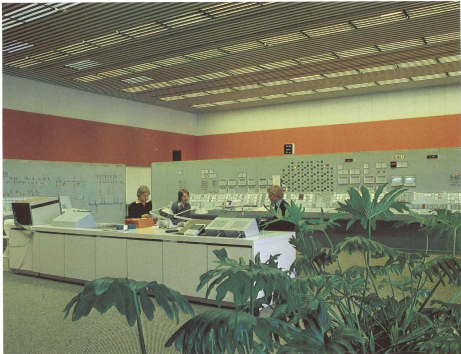
Centrala kontrollrummet för Barsebäck 2.
