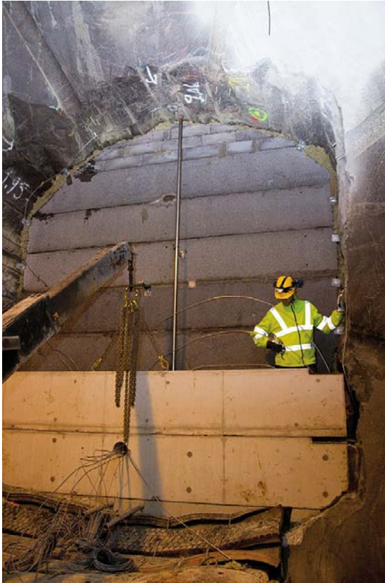
Figur 13-10. Installation av betongbalkar som utgör inre formvägg för betongkupolen i ett fullskaligt test av det kompletta pluggsystemet. Bakom betongbalkarna installeras bentonittätning, makadam, filter och givare.
