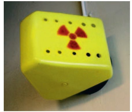
Lampan i reaktorhallen på Ågesta var en del av varningssystemet.
