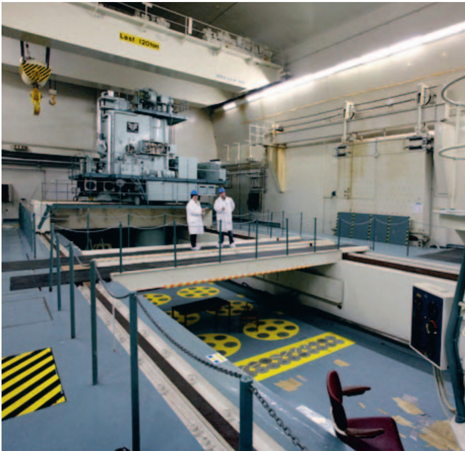
Sedan driften upphörde 1974 har reaktorhallen ekat tom. Men Svafo ser till att utrustning som kommer att behövas vid en framtida rivning, som strålskyddsportarna ut till transporttunneln, fungerar som de ska.
