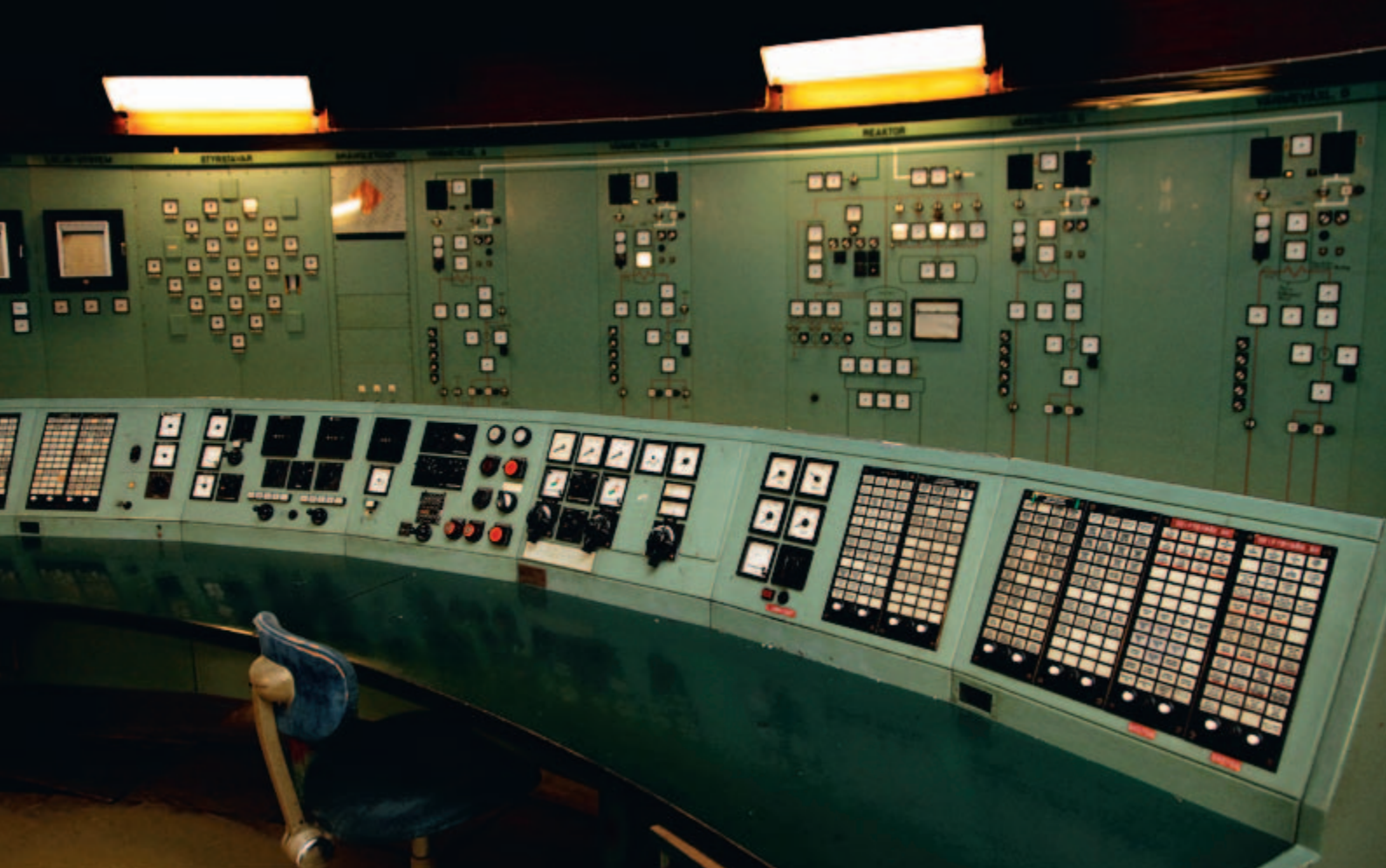
I kontrollrummet ser det mesta ut som när det begav sig. Instrumenten gav vägledning för personalen. Några datorer fanns inte att tillgå.
