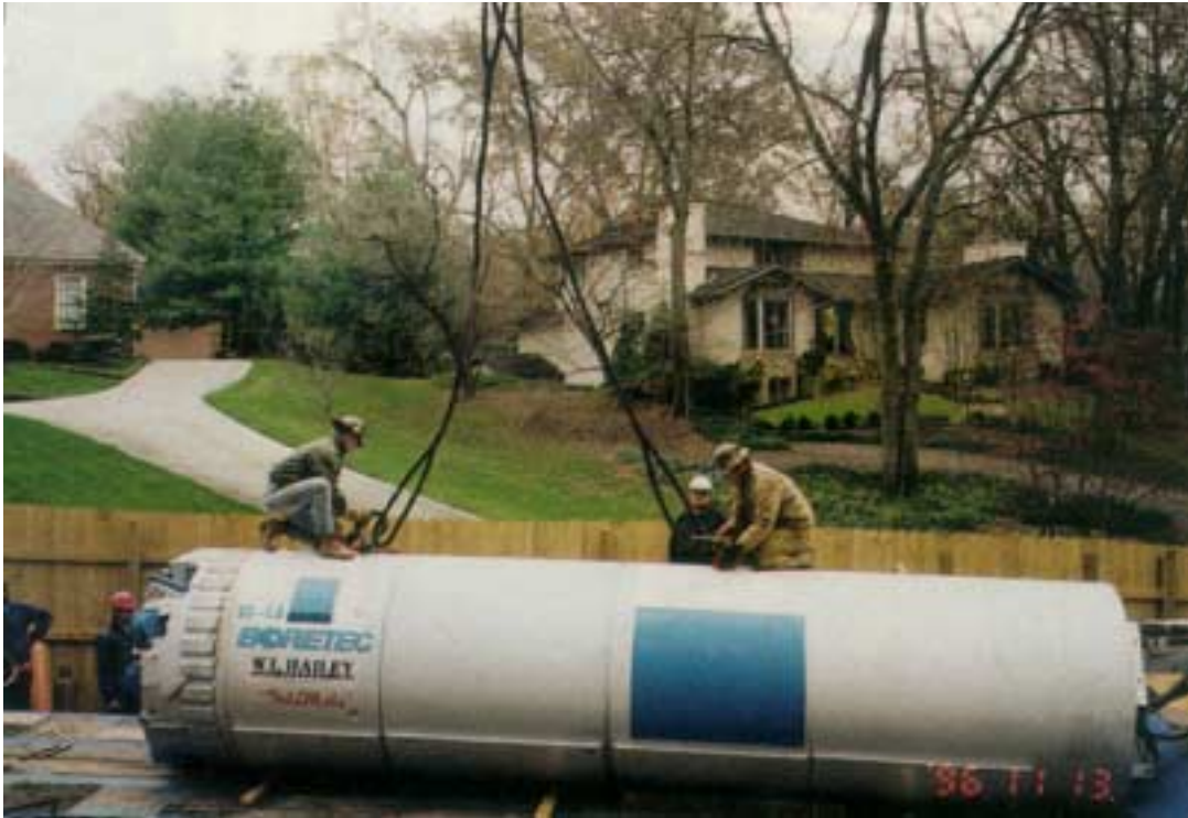
Figur 4-6 Figuren visar Boretecs MTBM "MITI Mole". Diametern är 1650mm och längden 6,7 m (från /9/).
