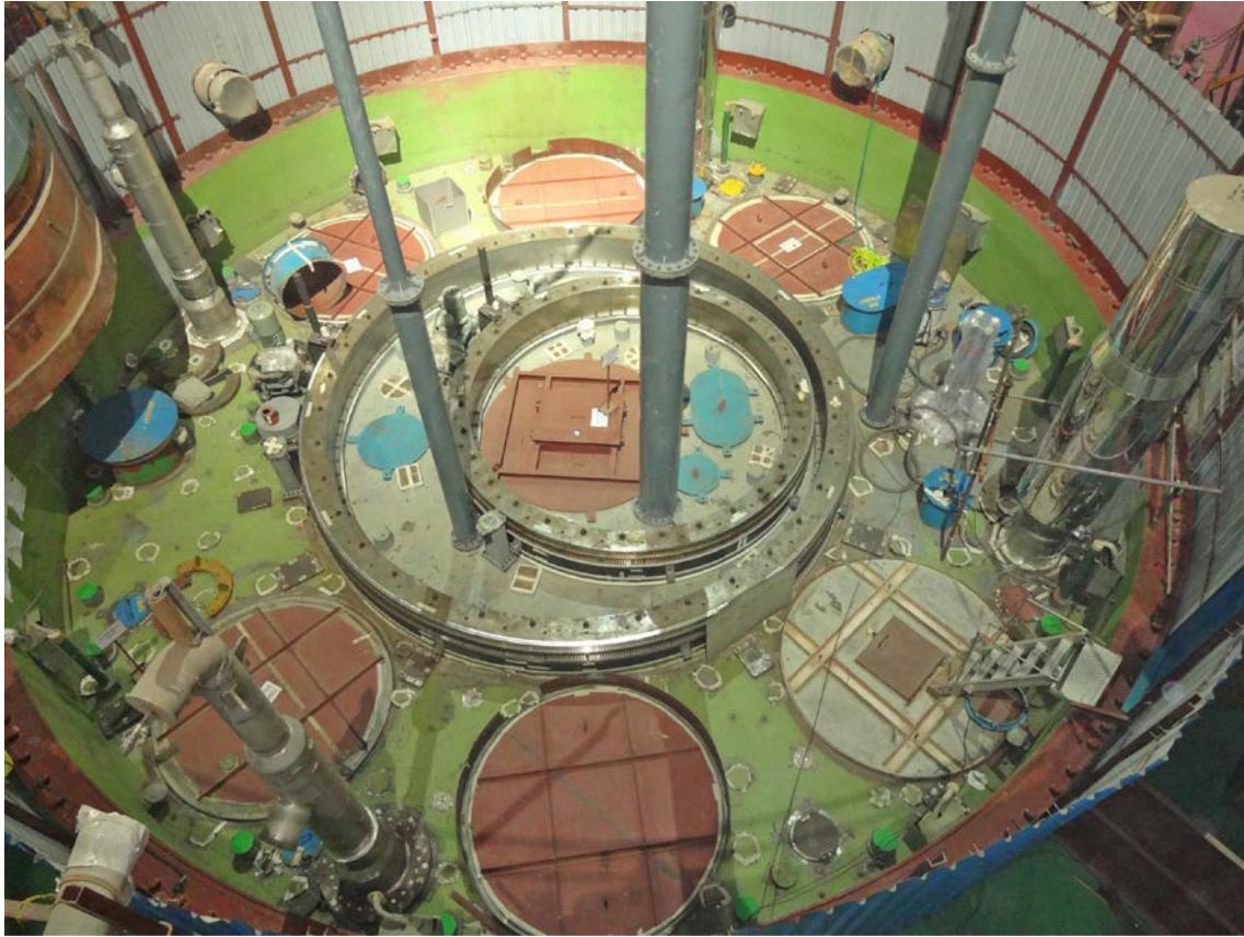
Figur 4-3. Vy över reaktorhallen i den indiska snabbreaktorn PFBR (Vasudeva Rao et al. 2013).
